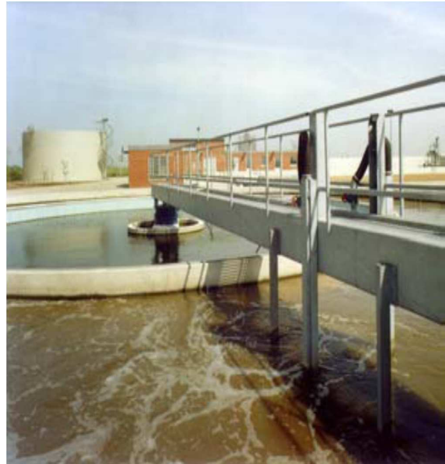
Trattamento Acque Reflue
